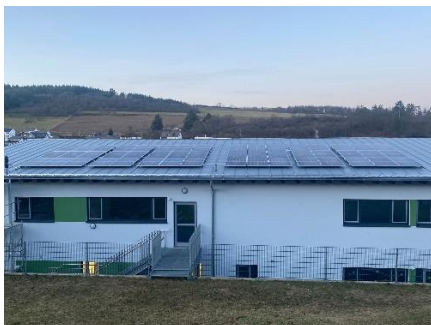
Photovoltaik-Anlage Grundschule Bad Endbach, Quelle: Landkreis Marburg-Biedenkopf
