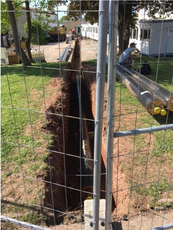
Ausbau Nahwärmenetz Alfred-Wegener-Schule, Kirchhain, Quelle: Landkreis Marburg-Biedenkopf
