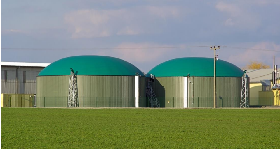
Fermenter Bioenergiedorf. Hier wird die Biomasse zu Biogas vergoren, Quelle: LianeM, Fotolia_6885307
