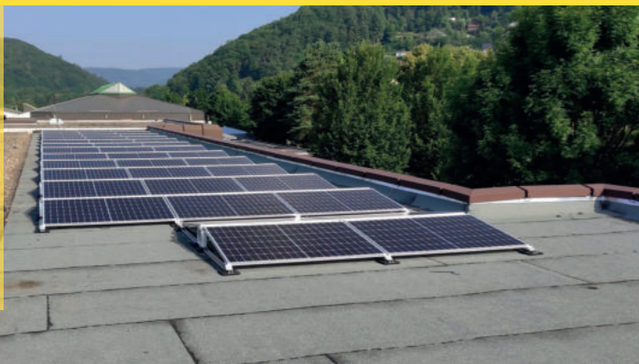
PV-Anlage auf der Lahntalschule in Biedenkopf Quelle: Florian Baumann, Landkreis
