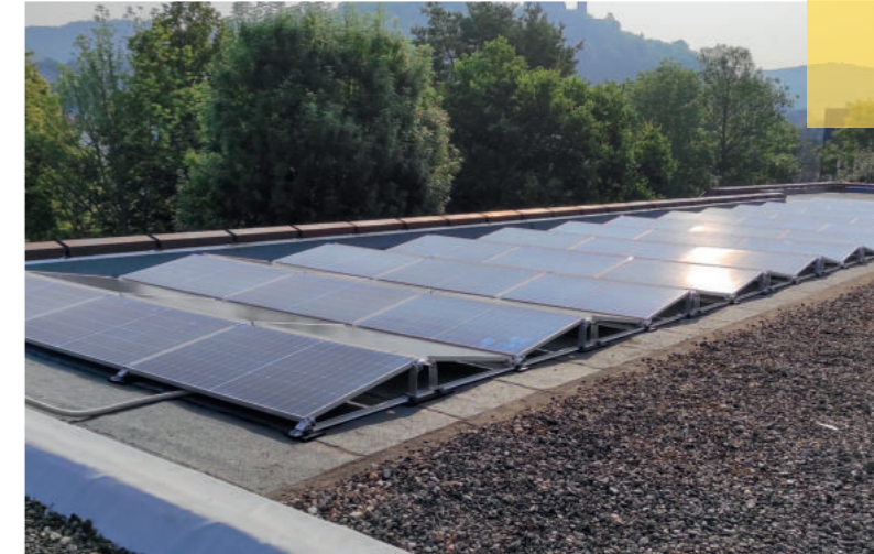
PV-Anlage auf der Lahntalschule in Biedenkopf Quelle: Florian Baumann, Landkreis
