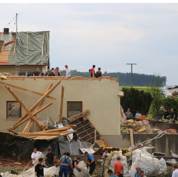
▼ Schäden durch einen Tornado in Affing (Bayern) am 13.5.2015.
