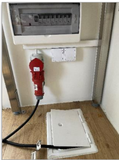
Bild 1: 16 A Anschluss im Spülmobil
