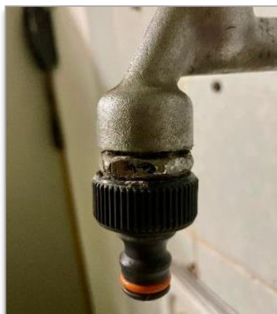
Bild 4: Trinkwasseranschluss außerhalb des Spülmobils
