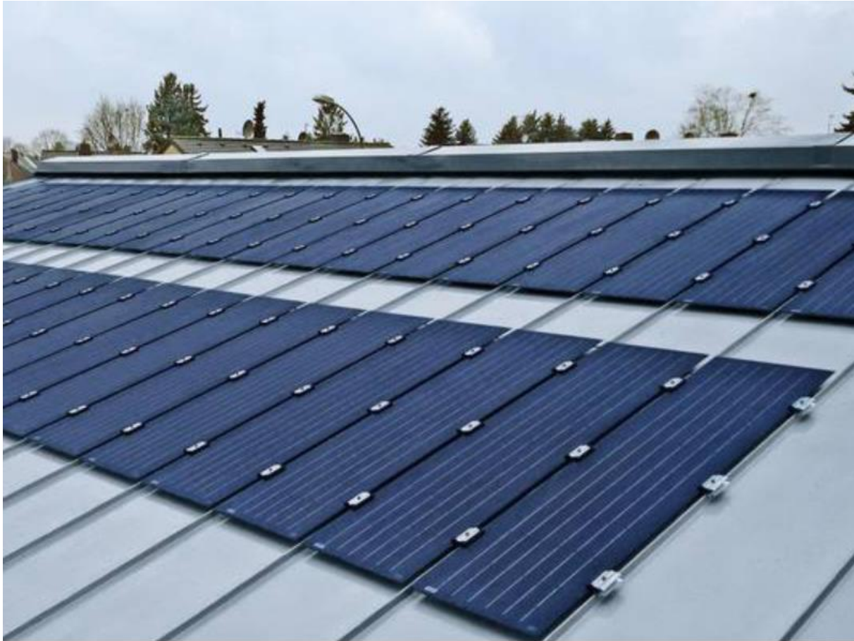
PV-Anlage auf einer Gemeinschaftsunterkunft in Wetter. Quelle: Eigentümerin der Immobilie
